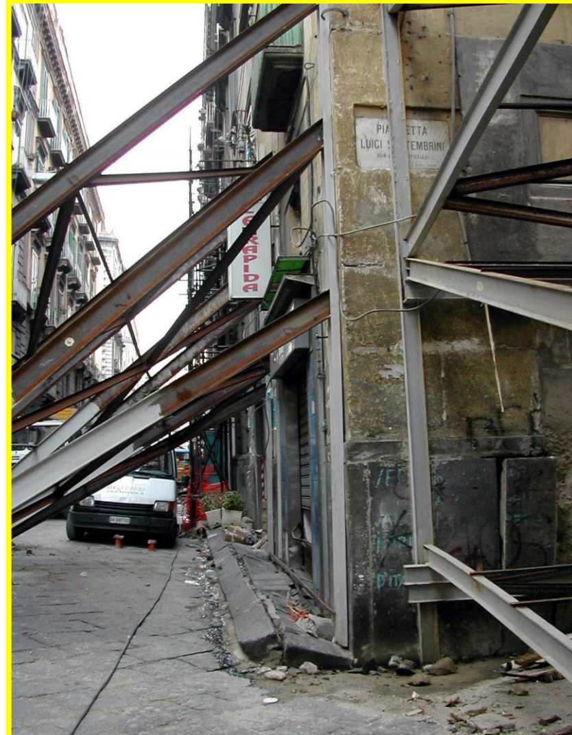
Colapso en Via L. Settembrini, Nápoles
