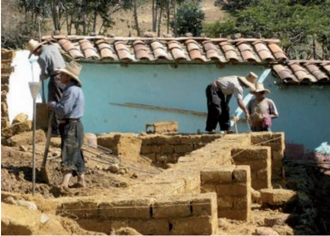
Figura 4.17. Pobladores trabajando para preparar el terreno para colocar la antena. Fuente: Edelnor (Distribuidora Eléctrica de Endesa en Perú).
